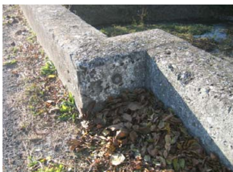
Absence d'étanchéité + non-conformité parapet
