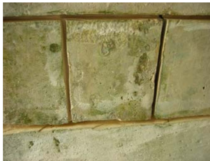
Disjoints des maçonneries
