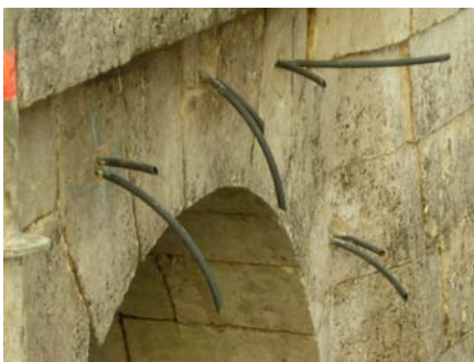
Canules d'injection des ancrages
