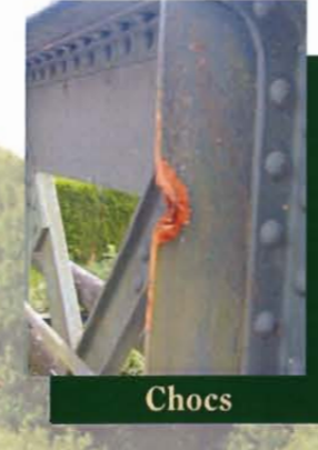
Altération de la peinture
